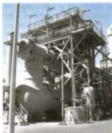
Рис. 106. Колонна синтеза аммиака
