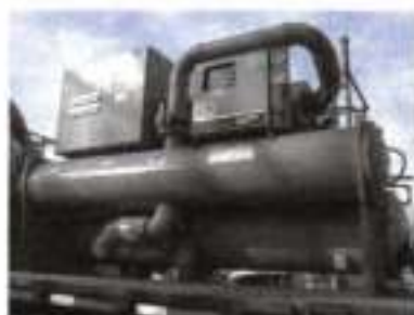
Рис. 30. Промышленная холодильная установка
