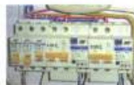
Рис. 91. Современный квартирный щиток с предохранителями
