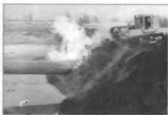
Авария на химически опасном объекте. Мощный взрыв повредил участок газопровода «Пермь — Горький». Ремонтно-восстановительные работы на месте взрыва. 10 декабря 2002 г.
