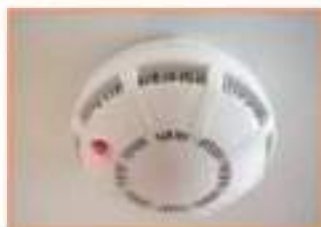
Рис. 4.7. Блок датчиков пожарной сигнализации
